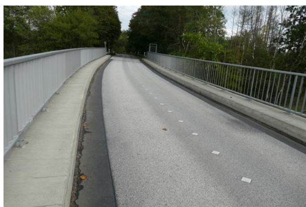
„Punktuelle“ Leitlinie im Engstellenbereich
