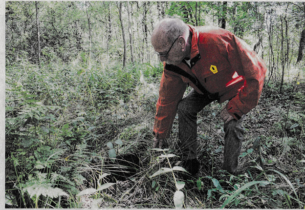
Ein kritischer Blick von Manfred Maier: Viele Staubretter, die zum Rückstau von Wasser in den Moorgräben aufgestellt wurden, sind nicht mehr im besten Zustand. Es werden neue benötigt, um das Holmmoor besser vernässen zu können. Foto: Antonio Balcazar
